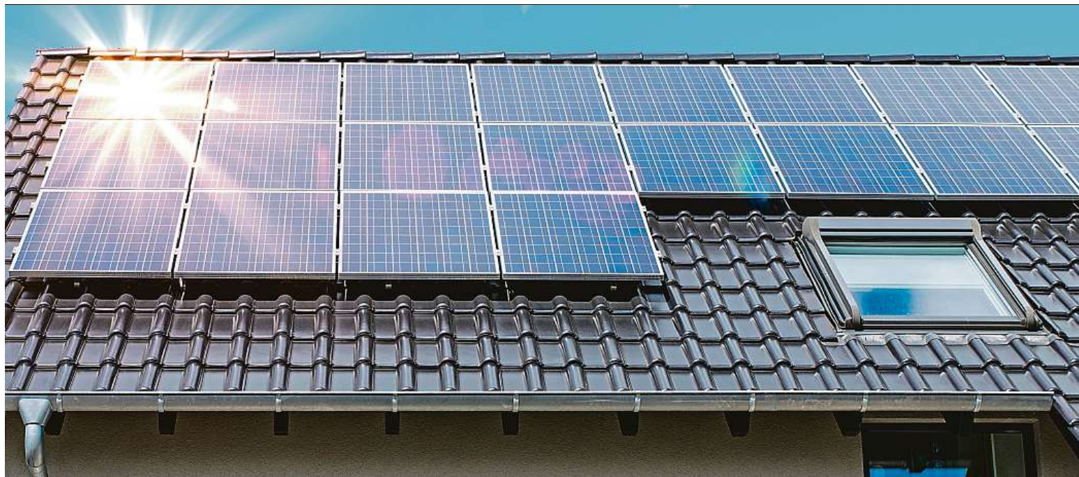
Solární boom V roce 2023 bylo do sítě připojeno celkem 82 799 solárních elektráren. Foto: Shutterstock
